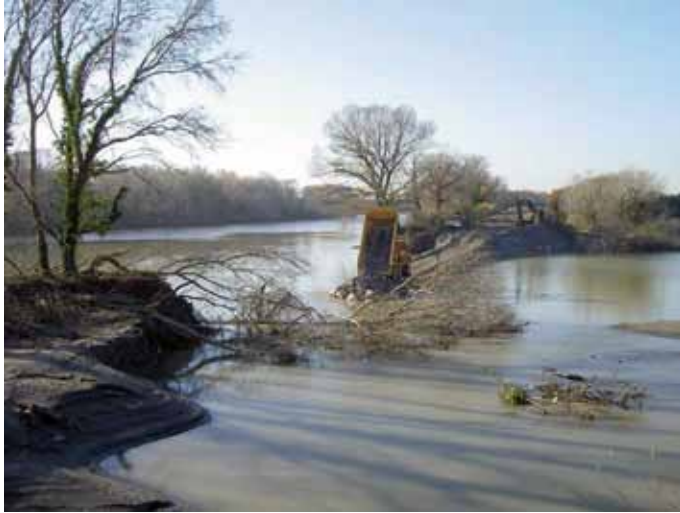
Photo 2 – La brèche de Petite Argence. ©SYMADREM
