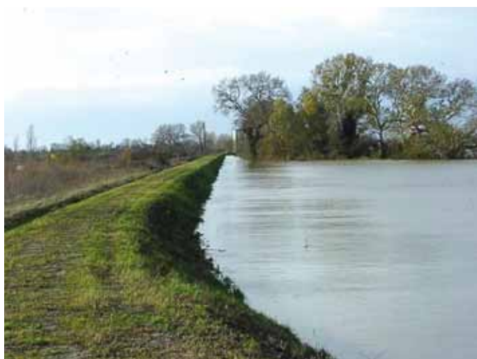
Photo 1 – Digue du Petit Rhône. L'accumulation sédimentaire dans le ségonnal étroit a réduit la revanche de l'ouvrage et accru le risque de débordement (ou de brèche) : ici lors de la crue de novembre 2002. © M. Provansal
