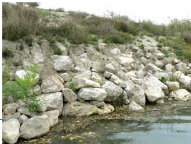
Photo 2 – Enrochement de berge effondré par sapement, crue de Novembre 2002. © M. Provansal
